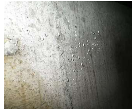
壁面に結露の発生
